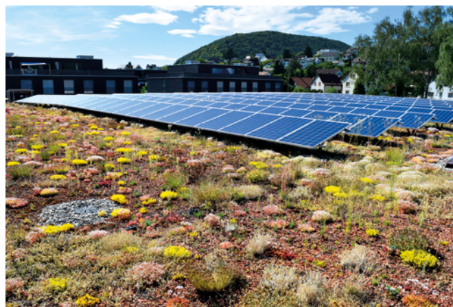
Abbildung 4: Extensive Dachbegrünung in Kombination mit PV-Anlage.
