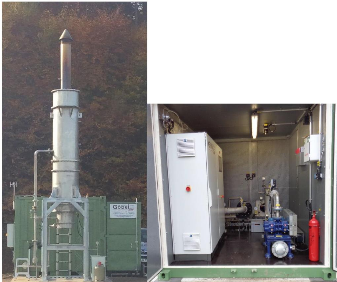
Schwachgasbehandlungsanlage inkl. Innenansicht des Containers, Fa. Göbels
