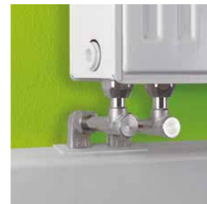
Heizungsleitungen in Sockelleiste
