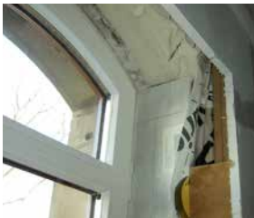
Außenwände und Fensterlaibungen werden von innen gedämmt und luftdicht mit einer Dampfbremssolie an den Fensterrahmen angeschlossen
