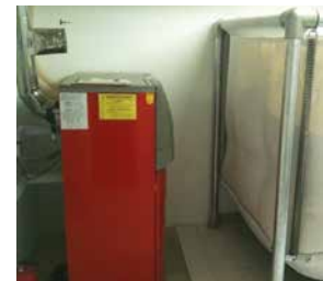
Pelletheizkessel mit Gewebesilo
