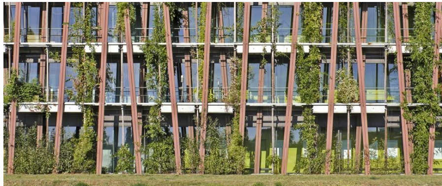
Abbildung 65 - Kombination aus boden- und fassadengebundener Begrünung am Institut für Physik, Humboldt-Universität, Berlin-Adlersdorf (Quelle: Nicole Pfoser 2009)
