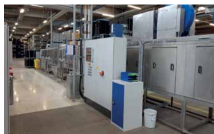
Eine Reinigungsanlage von Vario Pack.
