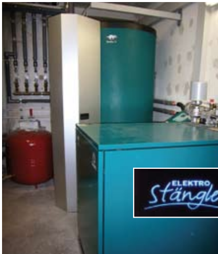
Das neue Blockheizkraftwerk.
